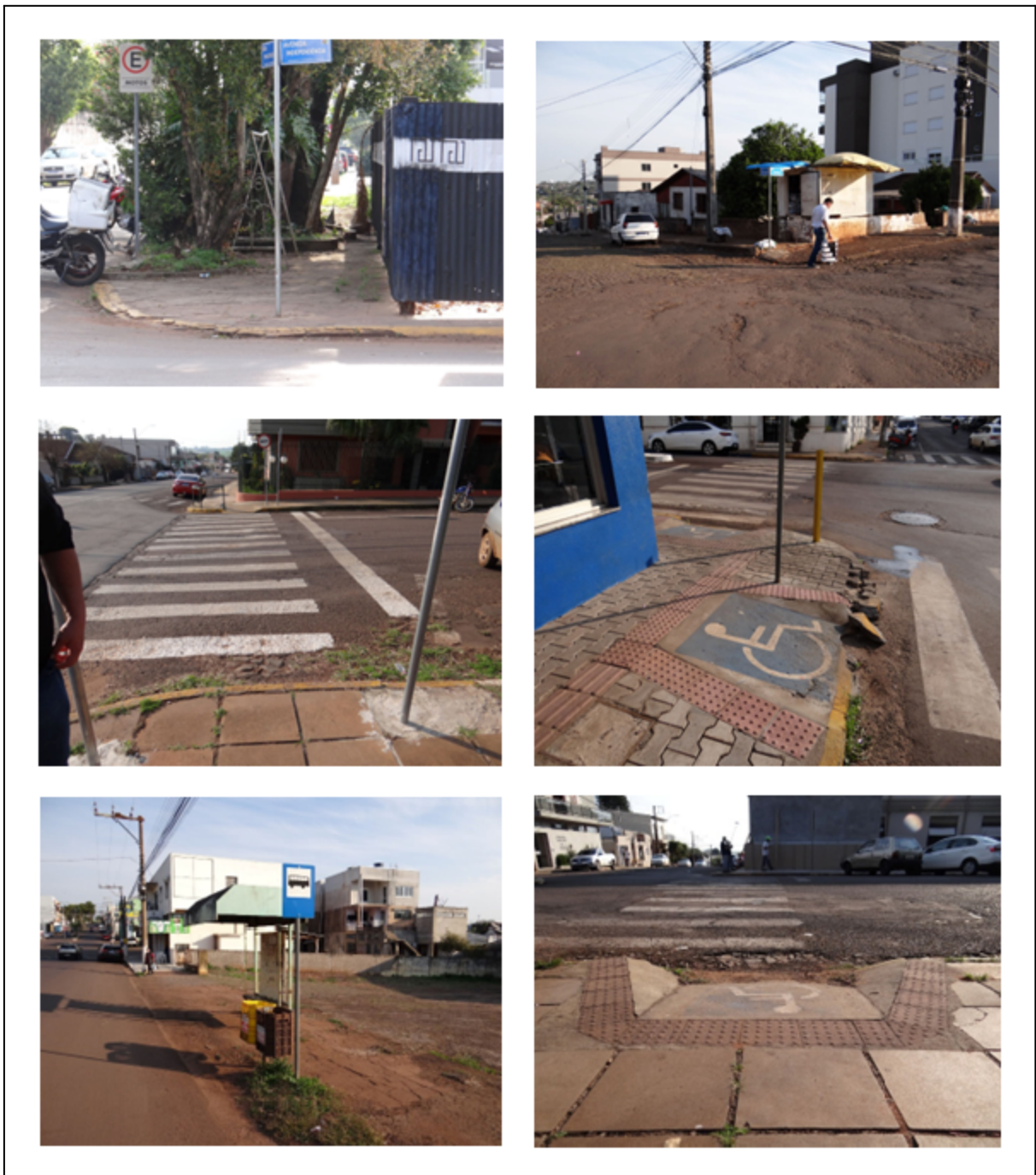
Figura 39: Problemas de infraestrutura nas calçadas na área central de Palmeira das Missões
