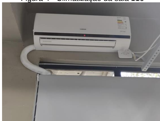
Figura 4 - Climatização da sala 116
