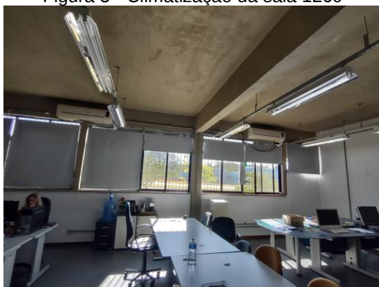
Figura 3 - Climatização da sala 126c
