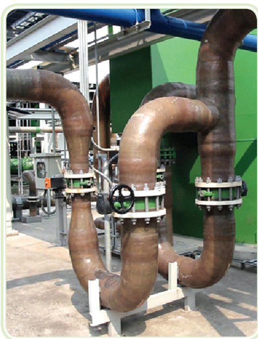
Figura 3.15: Tubulação de aço flangeada
