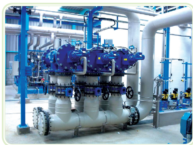
Figura 3.16: Tubulação de PVC
