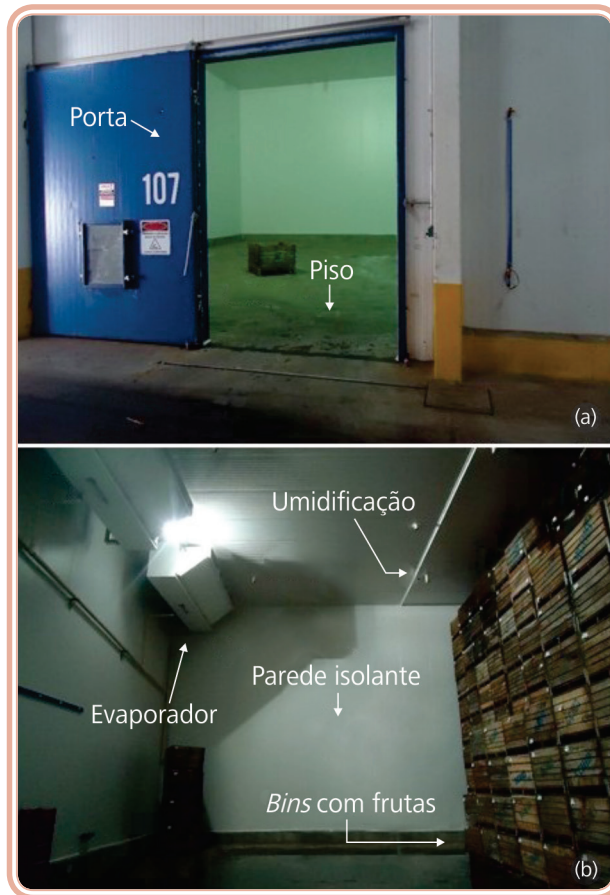
Figura 9.1: Câmara frigorífica de armazenamento de frutas e seus componentes, lado externo (a) e lado interno (b)
