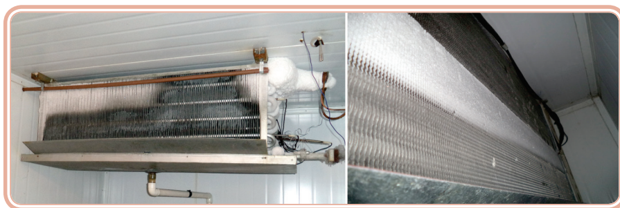
Figura 9.12: Evaporador da câmara com gelo, necessitando fazer degelo
