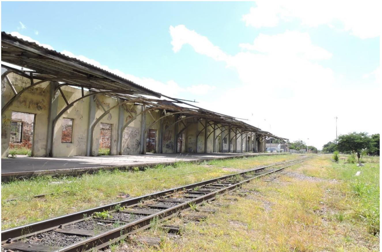
Figura 31: Estado atual (2019) dos prédios anexos oeste da Estação Férrea de Santa Maria/RS, na sua fachada norte, área da gare. Autor: Marcelo Gabriel Ercolani – 2019 (UFSM/NEFERS).
