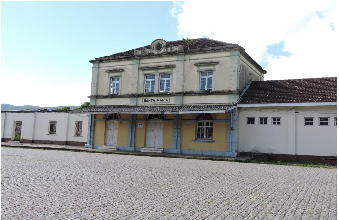
Figura 28: Estado atual (2019) do prédio principal da Estação Férrea de Santa Maria/RS. Autor: Marcelo Gabriel Ercolani – 2019 (UFSM/NEFERS).
