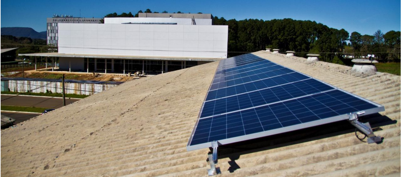
Figura 1 - Cobertura do colégio Politécnico da UFSM com sistema de geração de energia solar
