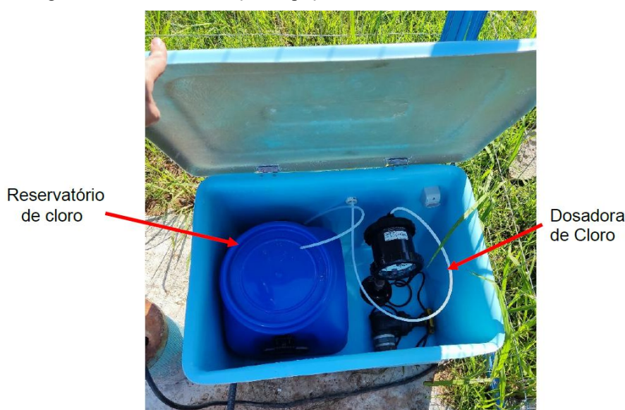
Figura 1 – Sistema de cloração do poço “Estrada Jardim Botânico - Trevo”
