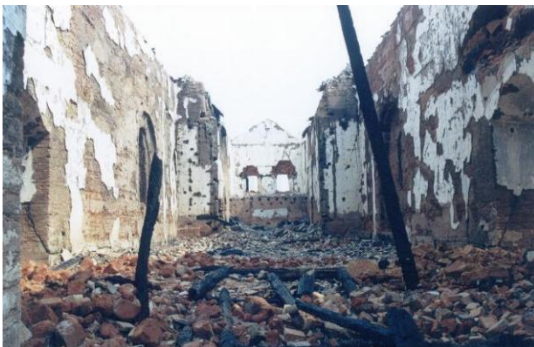
Figura 16 - Igreja após a destruição pelo incêndio.
