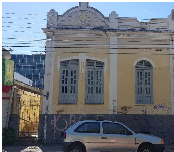
Figura 7.2 - Imagem frontal da edificação, com deformações.
