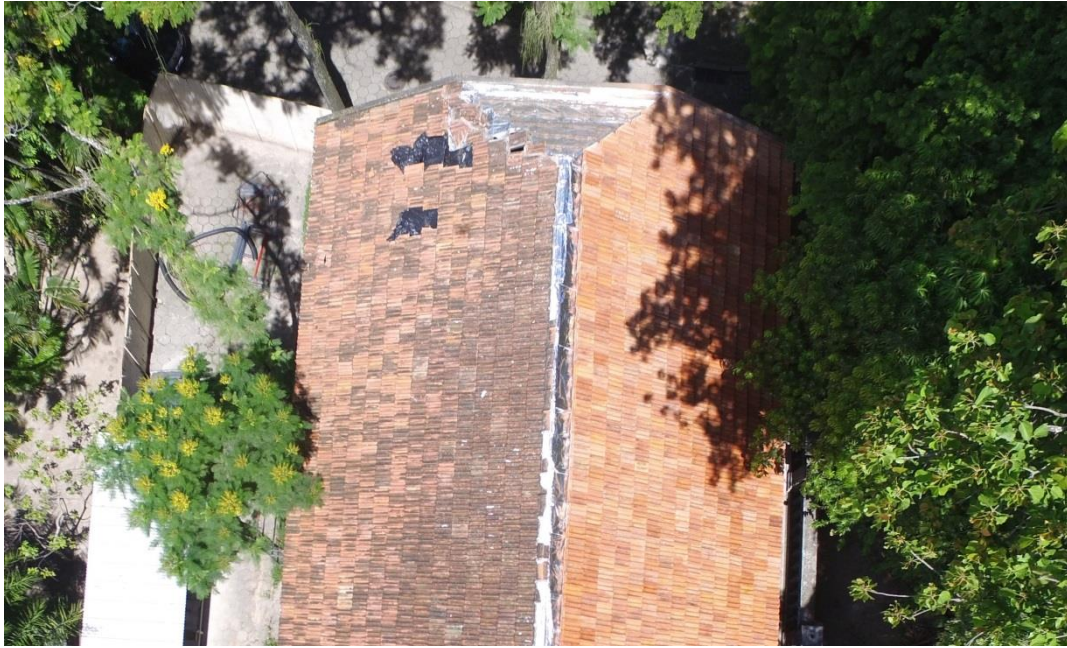
Figura 7 - Telhado do Anexo. Lado esquerdo telhas antes da intervenção, lado direito telhas recolocadas após tratamento. Foto aérea tirada em voo de drone. Fonte: DPH/COC.
