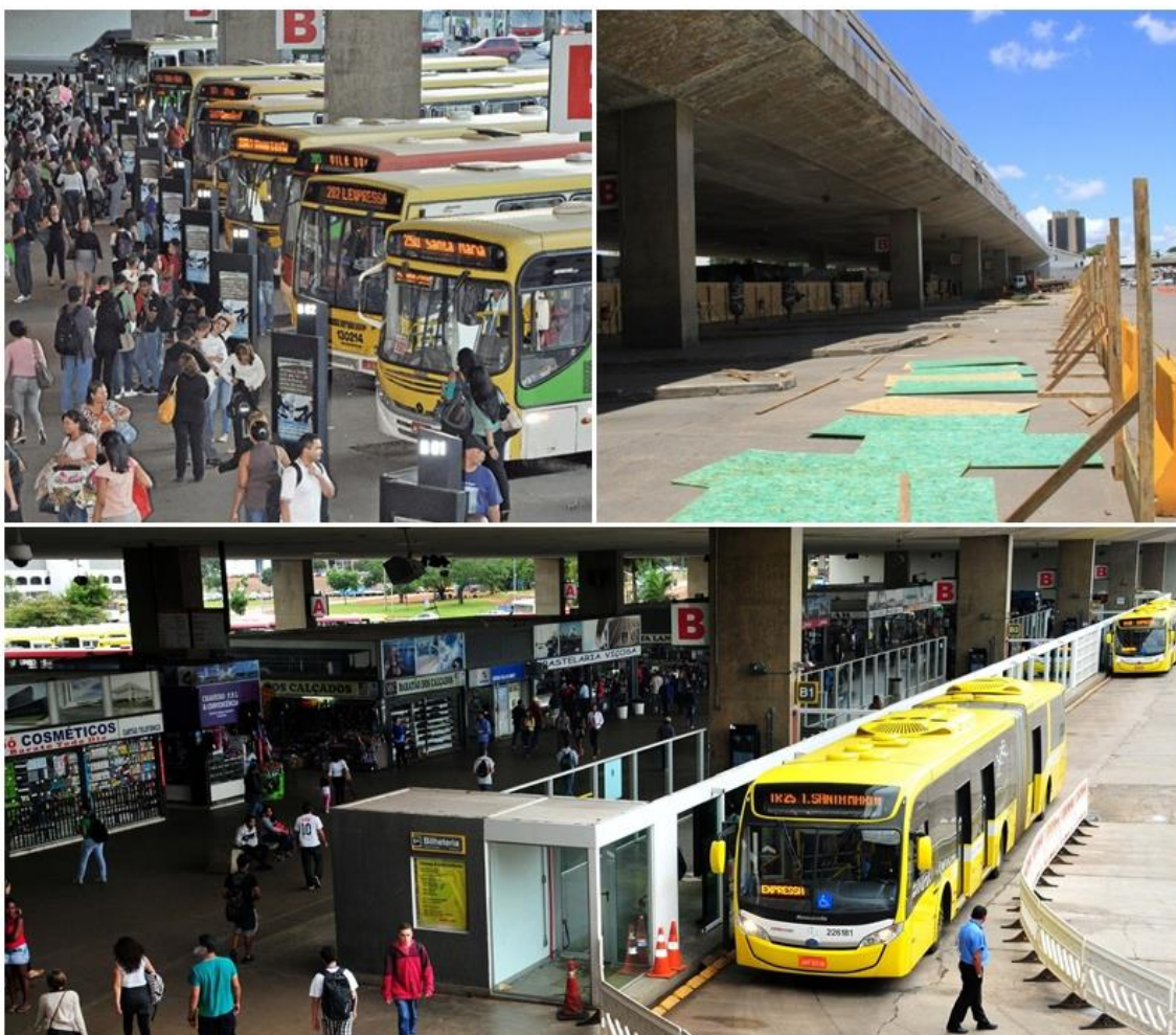
Figura 4 - Da esquerda para a direita: os boxes da Plataforma B na Rodoviária antes das obras do BRT; o local interditado para a construção dos módulos de embarque; e logo abaixo o embarque do BRT concluído e em funcionamento. Fonte: Agência Brasília
