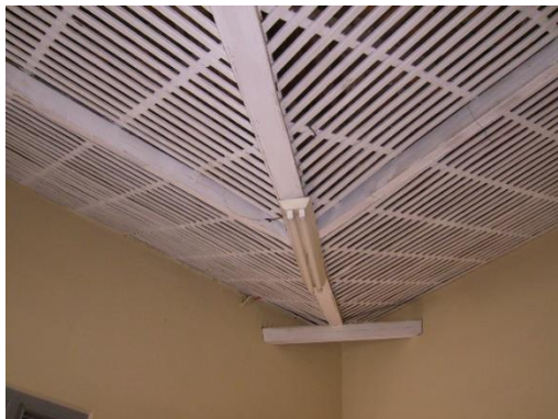
Forro ripado da cozinha da residência.
