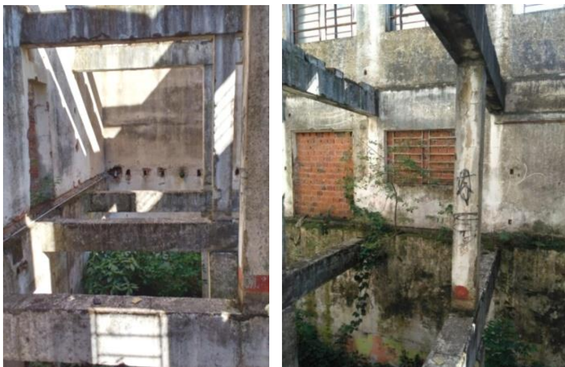
Figura 4 - Interior em ruínas do antigo Moinho Antoniazzi. Fonte: Acervo pessoal, 2019.
