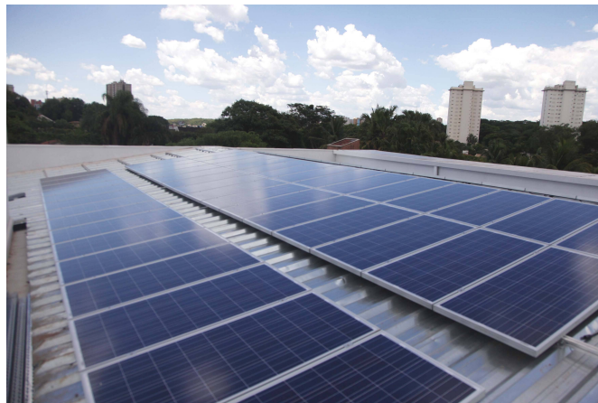
Figura 2 – Painéis fotovoltaicos instalados diretamente sobre um telhado
